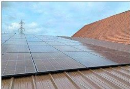
Solarstrom vom Bauernhof lässt sich dank der Möglichkeit, bestehende Netze zu nutzen, künftig besser vermarkten. (Bild: ju)
